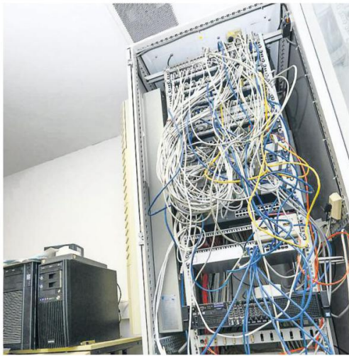
Blick in den Serverraum des Werner-Heisenberg-Gymnasiums. Dort wird sich in diesem Jahr eine Menge verändern. ARCHIVBILD: THOMAS RITTELMANN
